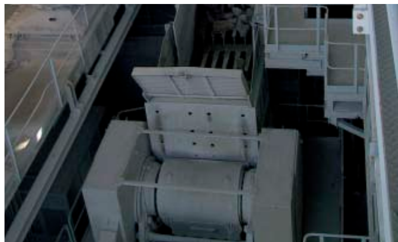
Dieser C200 ersetzte einen alten Pendelschwingenbrecher. Die Anlagenkapazität erhöhte sich, ohne dass Änderungen am Fundament erforderlich waren.
